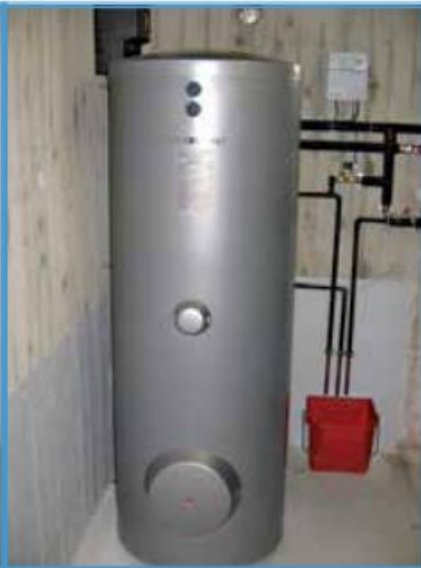
Spremnik za toplu vodu
